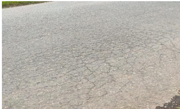
Gambar 1. 1 Retak kulit buaya ( alligator cracking ) pada STA 447+400
