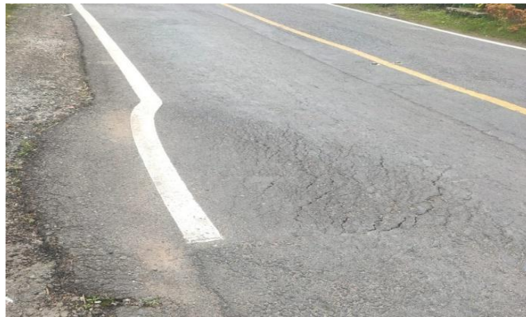
Gambar 1. 2 Kegelumutan ( Bleeding ) pada STA 445+100
