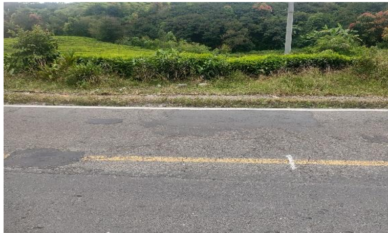
Gambar 1. 4 Agregat licin pada STA 444+600
