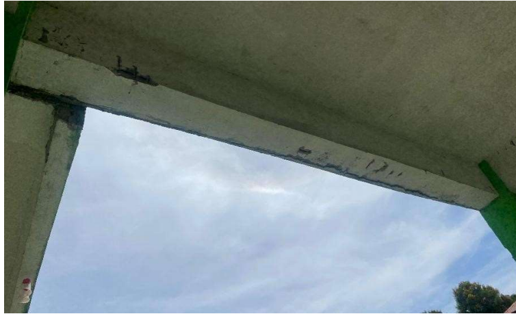
Gambar 1.2 Kondisi Balok SMP 3 Muhammadiyah Kota Padang
