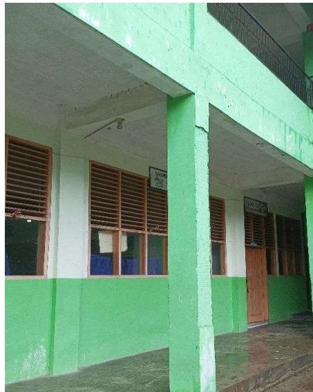
Gambar 1.3 Kondisi Kolom SMP 3 Muhammadiyah Kota Padang
