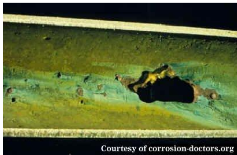
Gambar 2.9 Korosi Erosi Pada Pipa Air Laut
