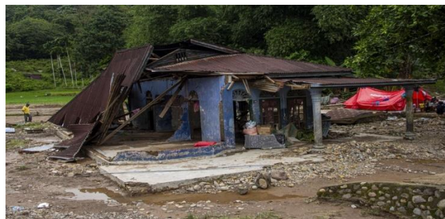
Gambar 1. 2 Kondisi rumah yang nyaris ambruk akibat di terjang banjir bandang di kampung Gantiang (Sumber : Data pribadi)
