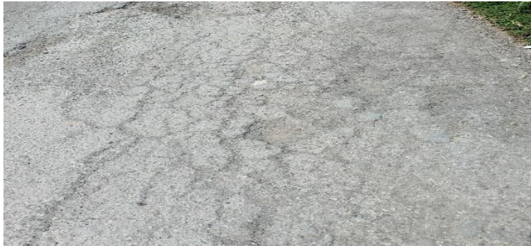
Gambar 1. 2Retak Rambut Buaya Di STA 385+100
