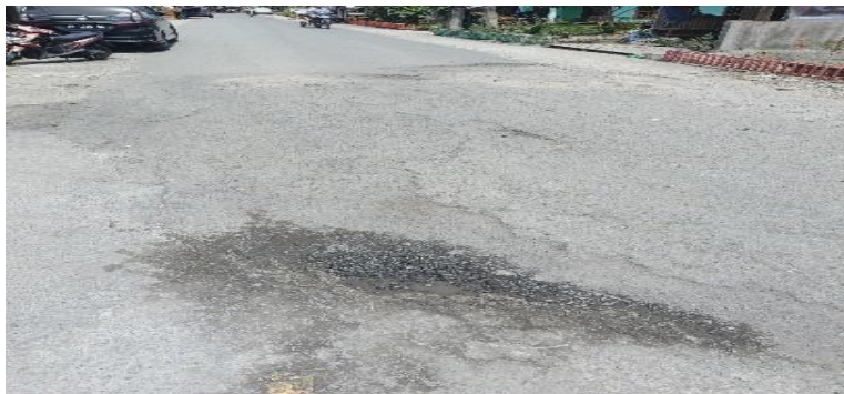
Gambar 1. 3Retak pingir Di STA 385+050
