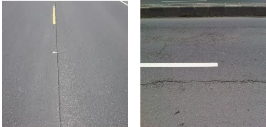
Gambar 1. 3 Retak Memanjang (Sumber : Dokumentasin Pribadi)
