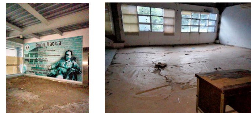
Gambar 1. 1 Penurunan tanah pada Perpustakaan
